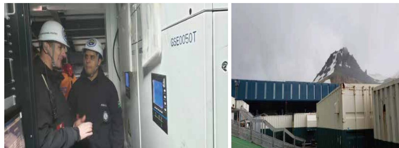
► 300 kWh Speicherprojekt der Antarktis-Forschungsstation des brasilianischen Militärs
