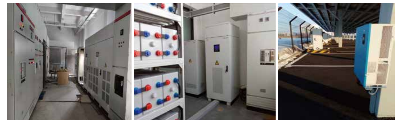
► BESS für EV-Ladestation in Harbin
